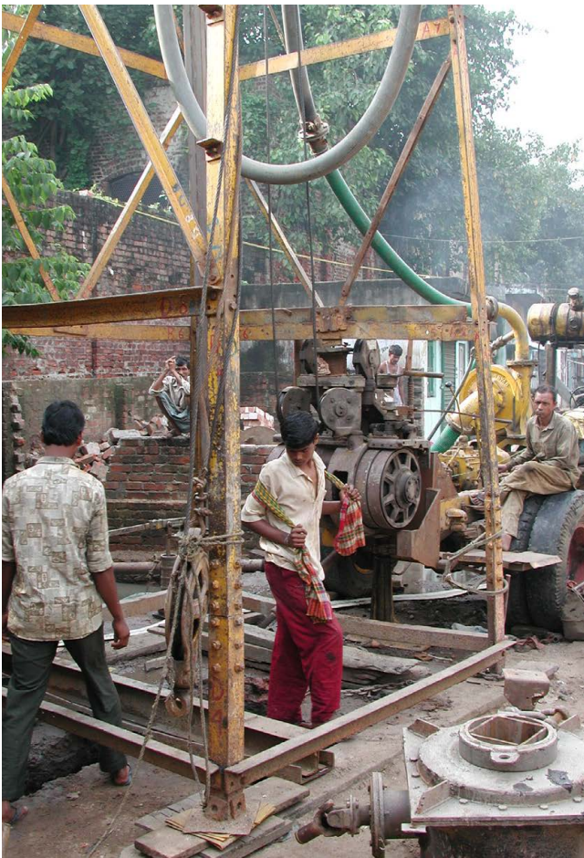
Infrastruktur zur Wasserversorgung, 2002
